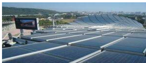
Toit photovoltaïque du stade de Koahsiunq, Taiwan
